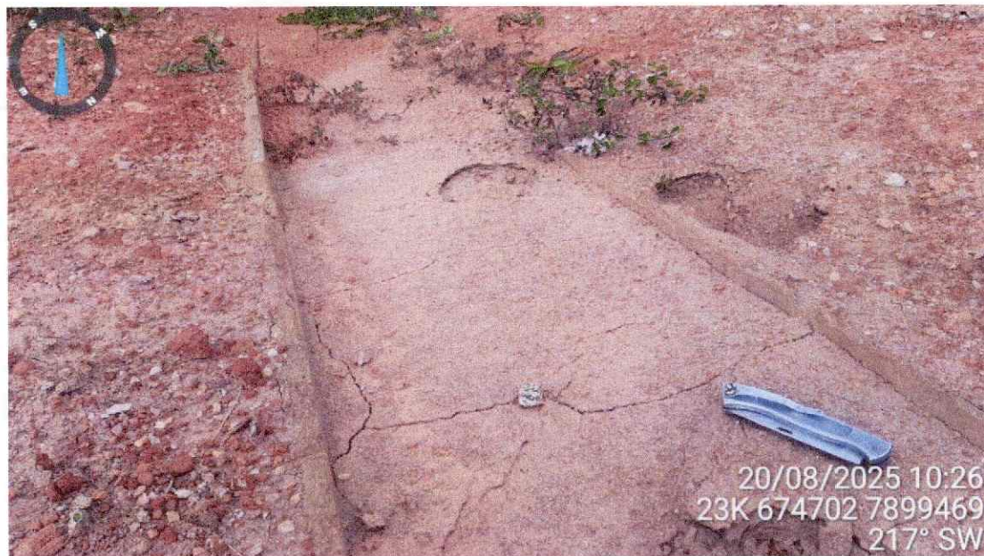
Imagem 10: Canaleta de concreto obstruída
