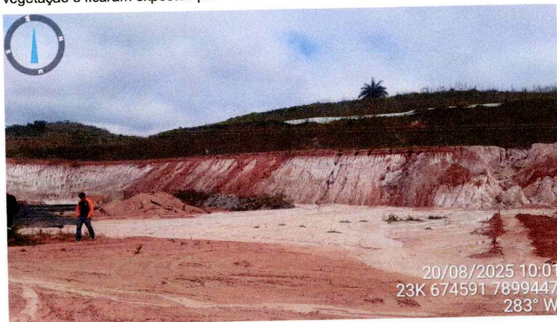
Imagem 06: Sulcos erosivos persistentes de abertura centi a decimétrica ao longo do talude.
