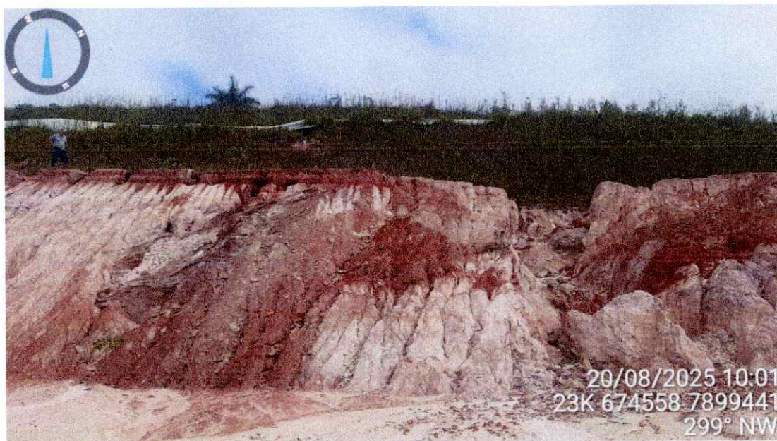
Imagem 03: Detalhe do sulco erosivo com acúmulo de água descrito na imagem 01
