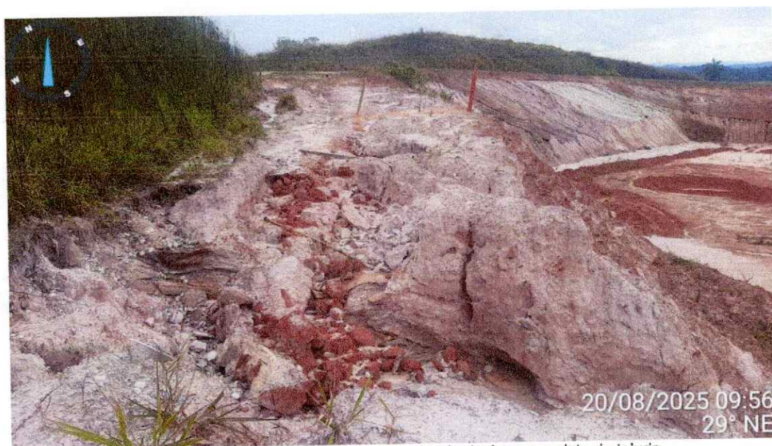
Imagem 05: Suíco erosivo e ponto de acúmulo de água na crista do talude.
