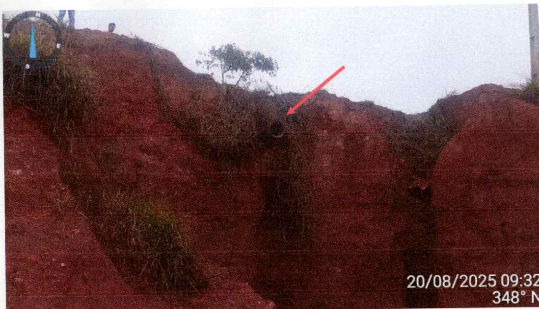
Imagem 07: Ravinamento exibindo manilhamento rompido
