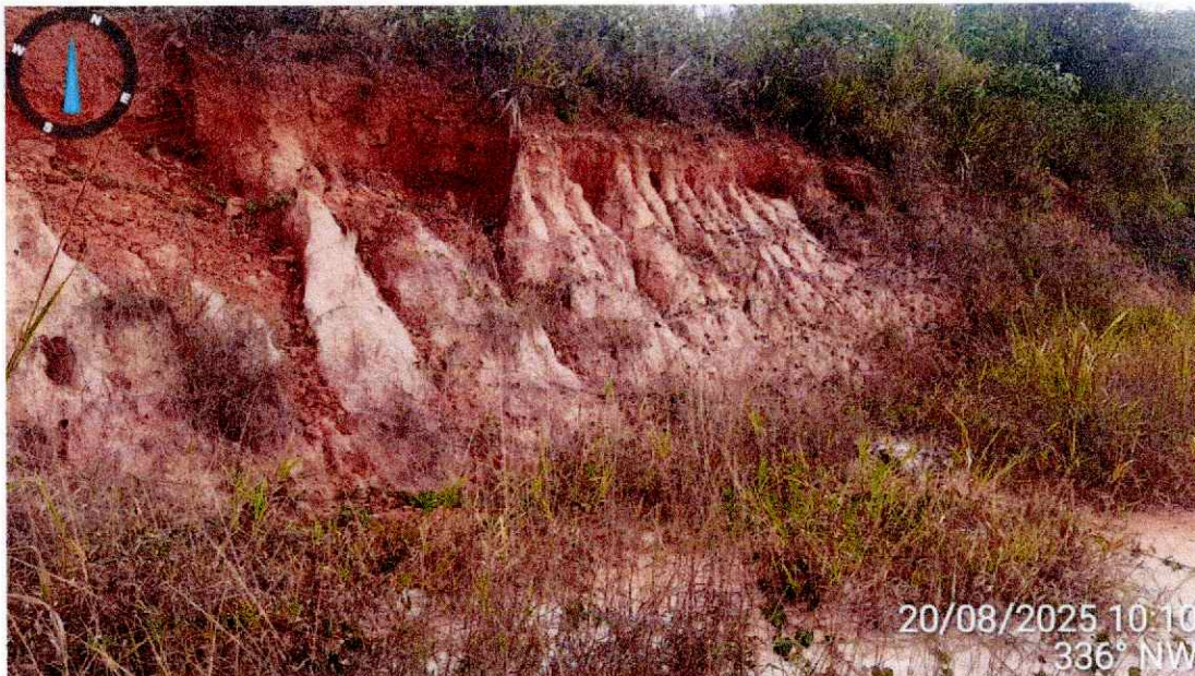
Imagem 08: Sulcos erosivos em talude
