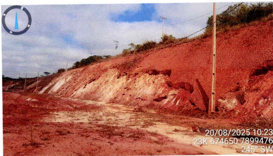
Imagem 11: Vista parcial do talude NW da planta de chorume. Materiais mais competentes são menos suscetíveis à erosão.
